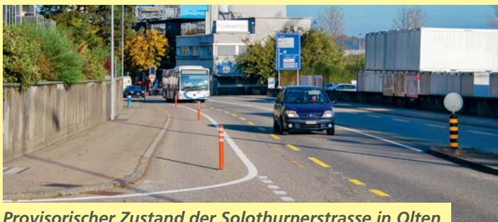
Provisorischer Zustand der Solothurnerstrasse in Olten
